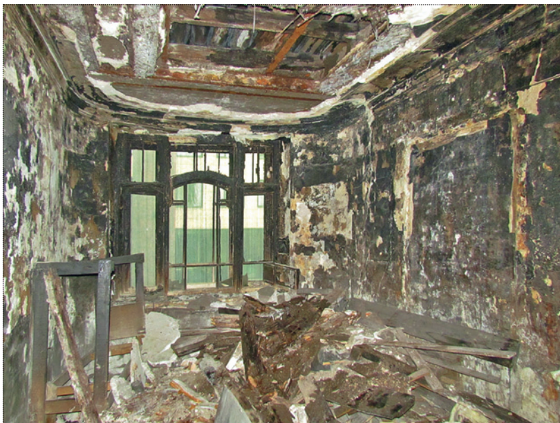
Внутреннее пространство после пожара. Фото 2012 года
