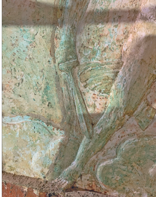
Утрата форм и деталей на барельефе северной стены. Фото 2020 года
