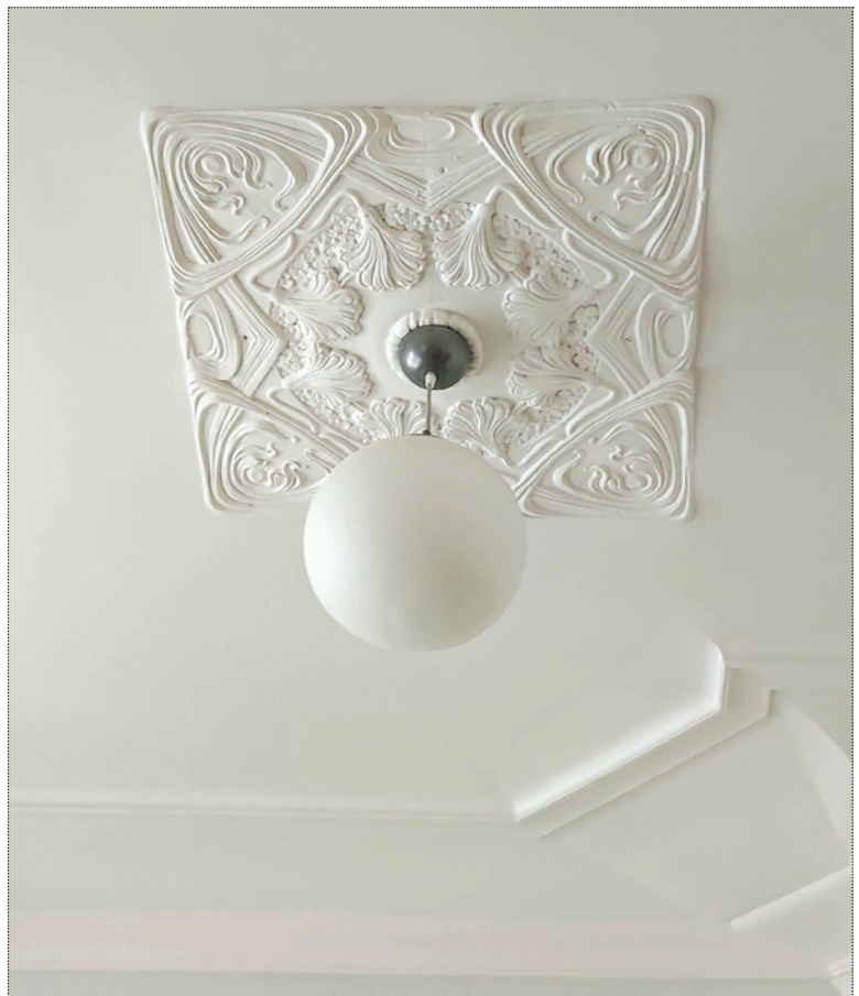
Розетка в помещении второго этажа. Фото 2021 года
