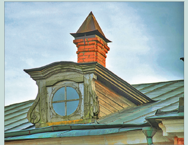
Господский дом усадьбы Ясенево. Слуховое окно на кровле. Фото: А. Александрова, 2021 год
