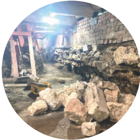
Разрушение фундаментов. Фото до реставрации
