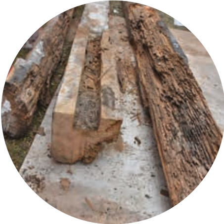
Состояние демонтированных деревянных балок
