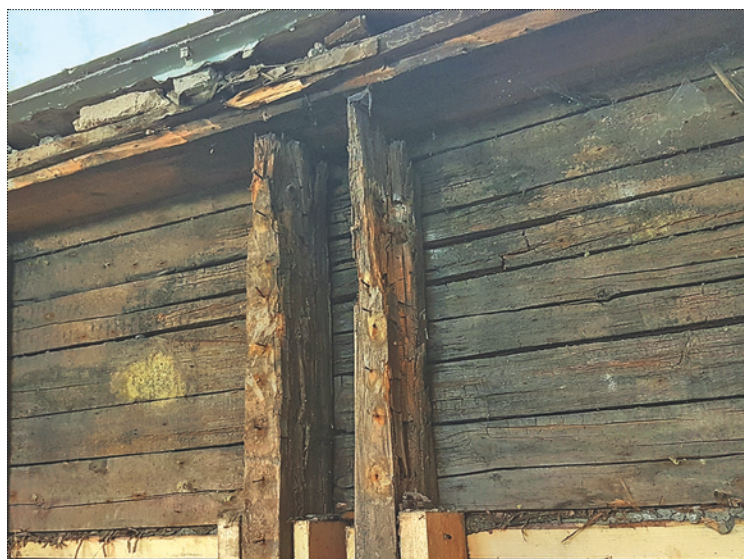
Состояние деревянной конструкции павильона до реставрации. Фото: ТМ «КИТЕЖ», 2020 год
