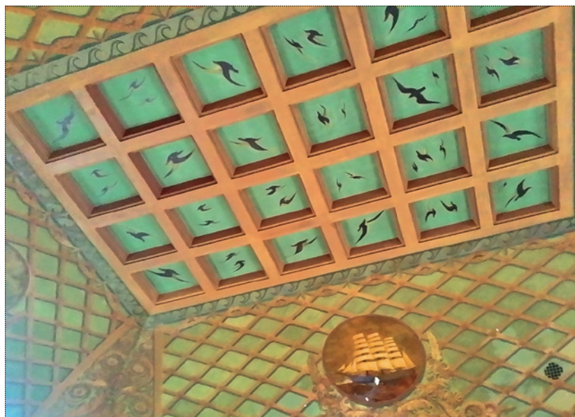
Потолок ресторана до реставрации. Фото 2017 года
