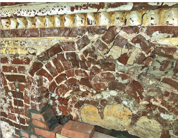
Раскрытие наличника окна 2-го этажа. Фото 2018 года
