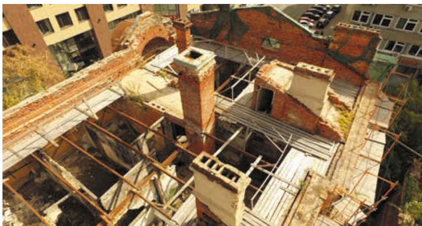
Состояние дома Быкова на начало противоаварийных работ. Фото В. Кузнецов, 2013 год
